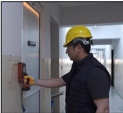
Şekil 3. Donatı tarama cihazı ile kolonlardaki donatıların sayı ve yerlerinin belirlenmesi (A.Ferdi Şenol).
