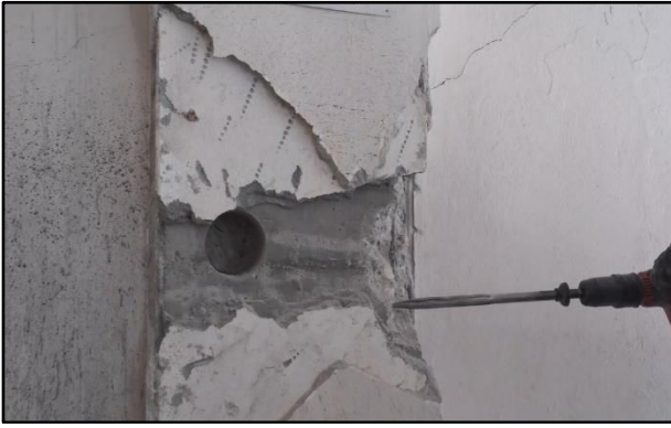
Şekil 2. Kolonlarda beton örtüsünün sıyrılması (A.Ferdi Şenol).
