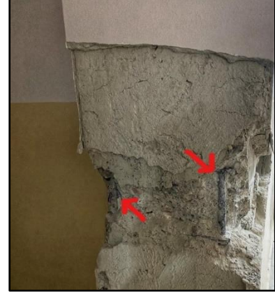
Şekil 6. Kolonda beton sıyırması ve donatı sınıfı tayini (A.Ferdi Şenol).
