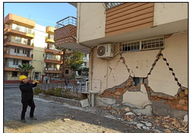
Şekil 4. Dolgu duvarlarda kesme çatlakları ve tuğlaların ezilmesi. (İskenderun, Fotoğraf; A.Ferdi Şenol).
