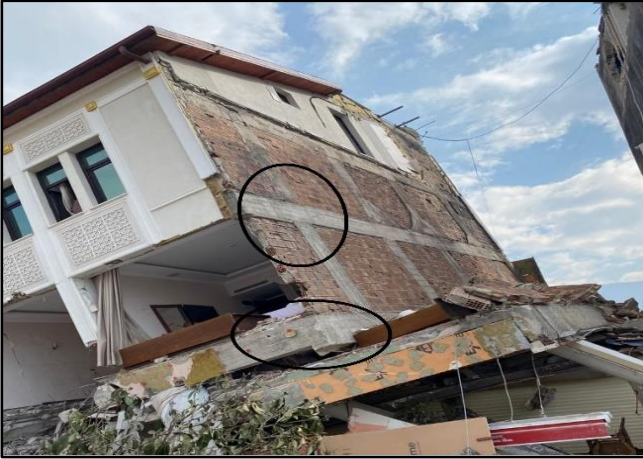
Şekil 9. Güçlü kiriş-zayıf kolon etkisi (Antakya, Fotoğraf; A.Ferdi Şenol).
