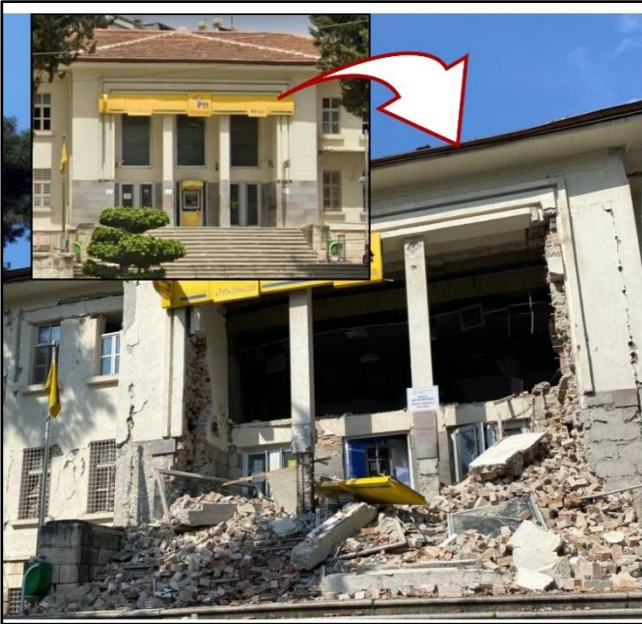
Şekil 6. Antakya'nın tarihi postanesinde meydana gelen hasar öncesi ve sonrası (Antakya, Fotoğraf: A.Ferdi Şenol).
