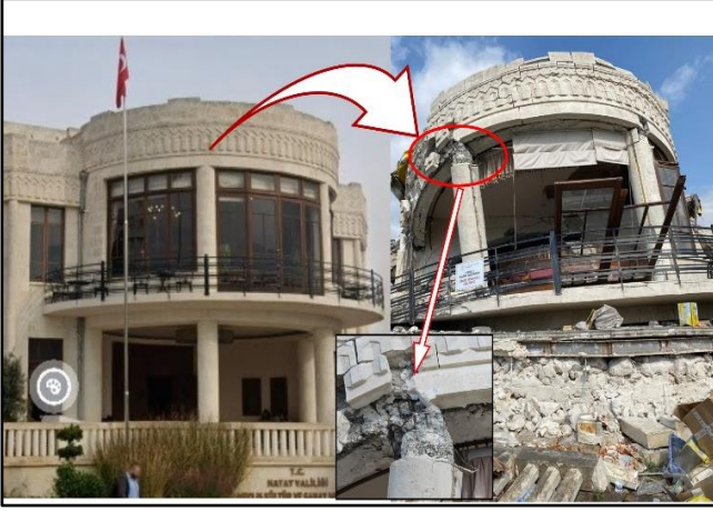
Şekil 5. Hatay Meclis ve Kültür Sanat Merkezi yapısında meydana gelen hasar öncesi ve sonrası (Antakya, Fotoğraf: A.Ferdi Şenol).
