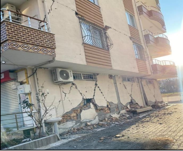
Şekil 14. Dolgu duvar hasarları (İskenderun, Fotoğraf; A.Ferdi Şenol).
