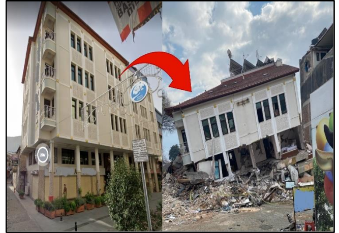
Şekil 7. Yumuşak kat etkisi ile göçme hasarı öncesi ve sonrası. (Antakya, Fotoğraf; A.Ferdi Şenol).
