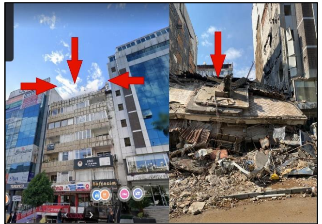
Şekil 11. Bitişik nizam etkisi ile hasar öncesi ve sonrası (Antakya, Fotoğraf; A. Ferdi Şenol).
