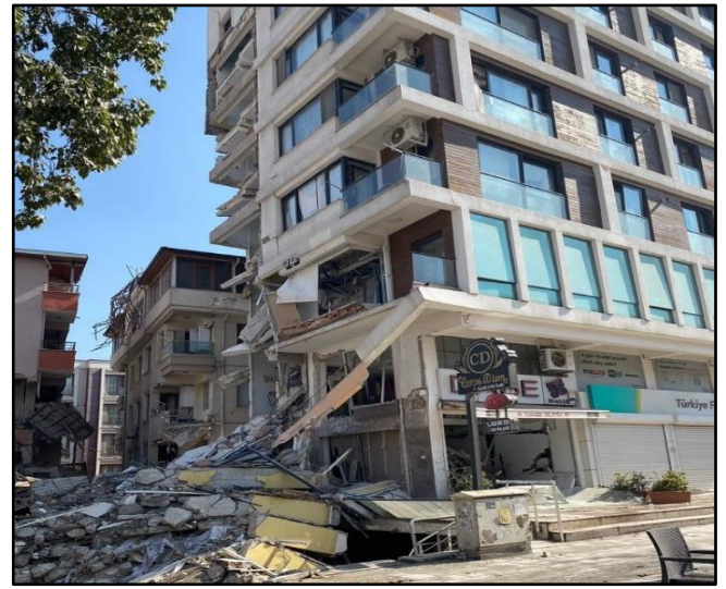
Şekil 3. Bina taşıyıcı sistemindeki yapı elemanlarında ayrılma. (Antakya, Fotoğraf; A.Ferdi Şenol).
