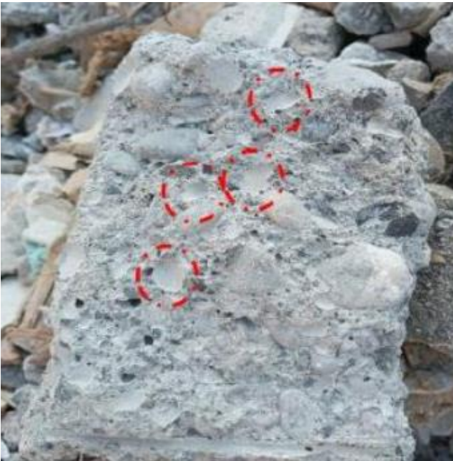
Şekil 5. Malzeme Kaynaklı Hasarlar – Beton
