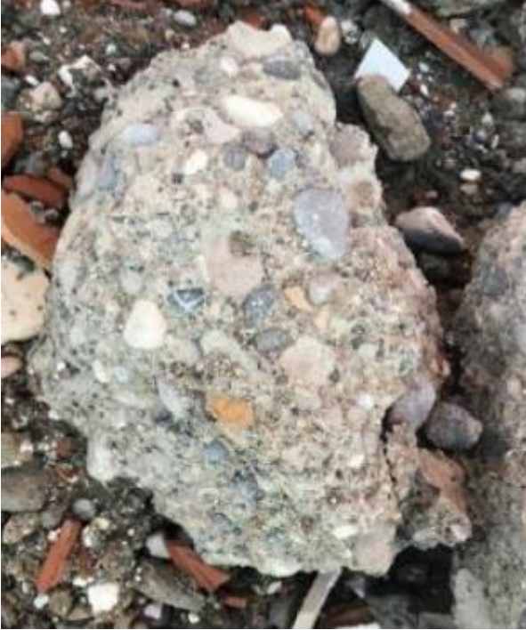
Şekil 4. Malzeme Kaynaklı Hasarlar – Beton
