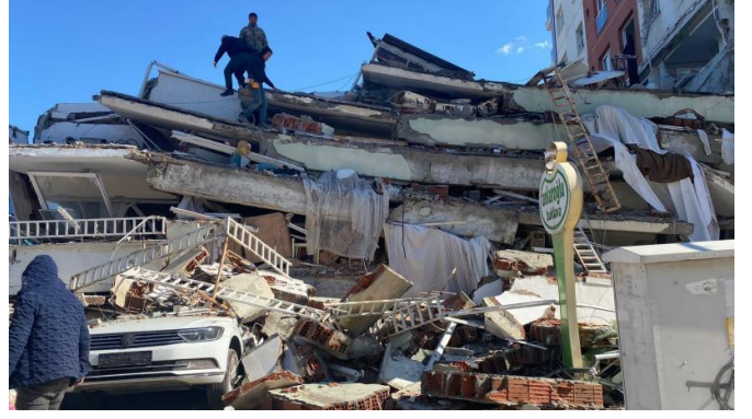
Şekil 13. Uygulama Kaynaklı Hasarlar- Zayıf Kolon Güçlü Kiriş Problemi
