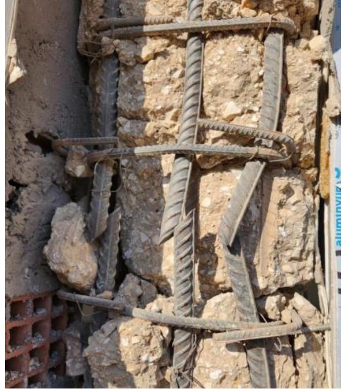
Şekil 16. Uygulama Kaynaklı Hasarlar- Etriyelerin 90 derece bağlanması ve düşük kaliteli donatı (karbon oranı yüksek)
