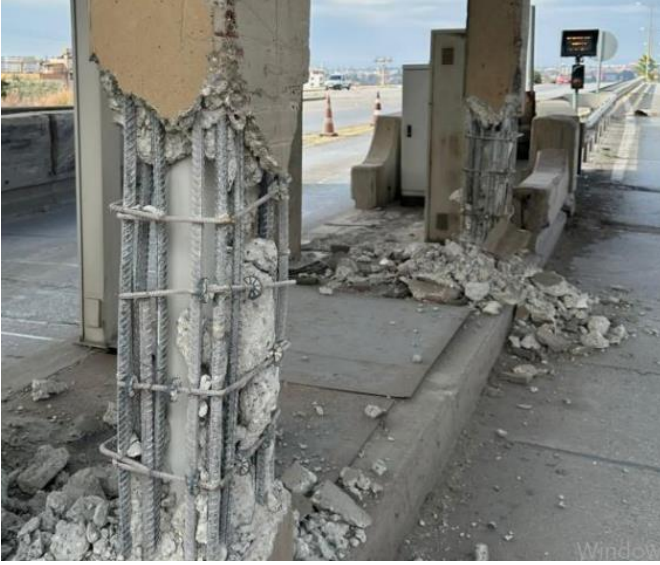
Şekil 16. Uygulama Kaynaklı Hasarlar- Etriyelerin 90 derece bağlanması
