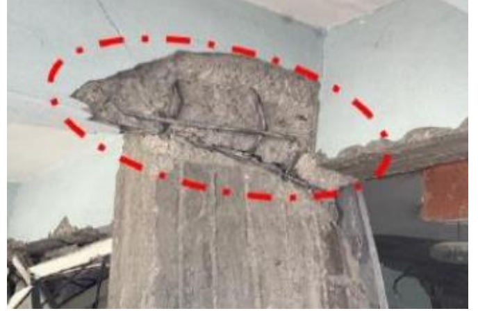
Şekil 9. Malzeme Kaynaklı Hasarlar – Donatı
