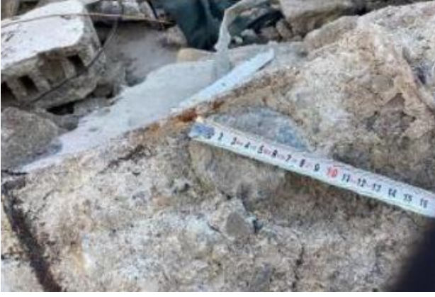
Şekil 7. Malzeme Kaynaklı Hasarlar – Beton
