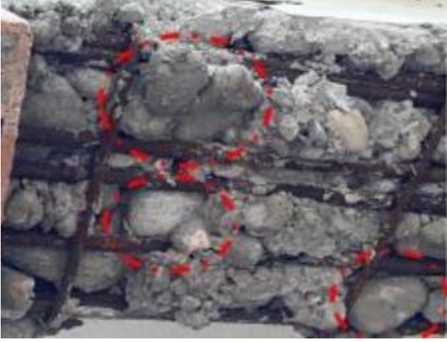
Şekil 8. Malzeme Kaynaklı Hasarlar – Beton
