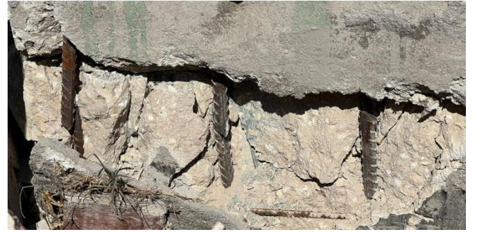
Şekil 10. Malzeme Kaynaklı Hasarlar – Donatı
