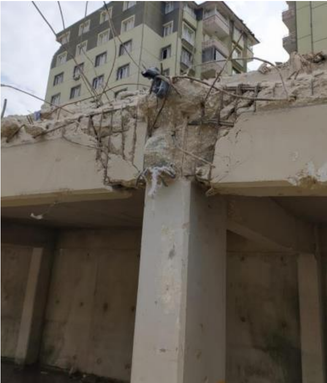
Şekil 13. Uygulama Kaynaklı Hasarlar- Kolon Kiriş Birleşimi
