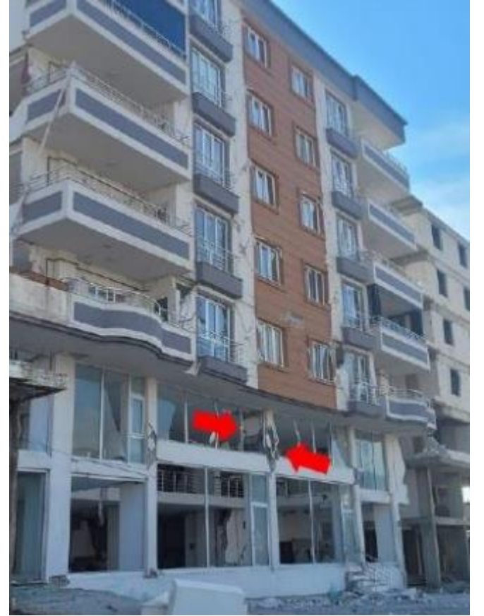
Şekil 14. Uygulama Kaynaklı Hasarlar- Kısa Kolon
