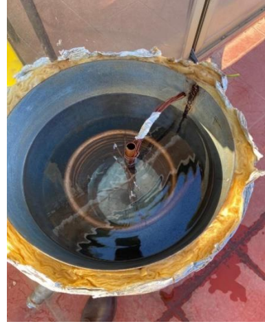
Şekil 3. Sıcak su deposu
