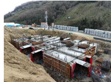
Şekil 10. Tünel Kalıp Sistemi Beton Dökümü ve Kürleme İşlemi Tamamlanan Kalıpları Sökülecek Kat Görseli (A. Hasan DUMAN)
