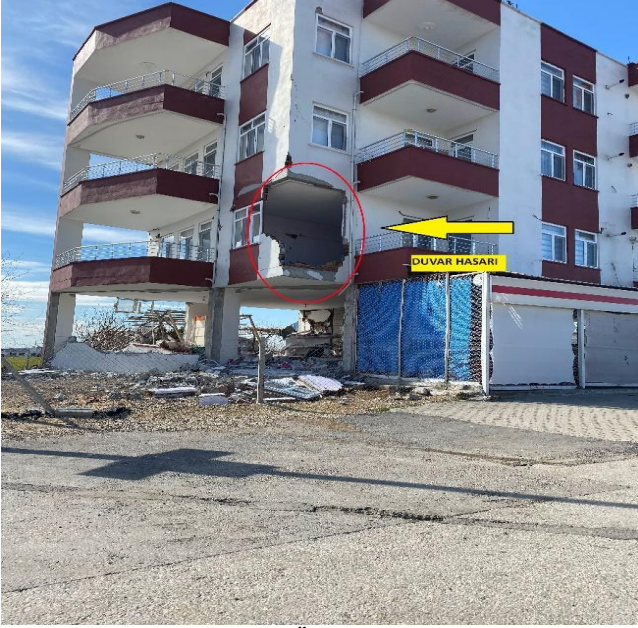
Şekil 11. Ağır Çıkmalar Üzerindeki Dolgu Duvarların Hasar Durumları
