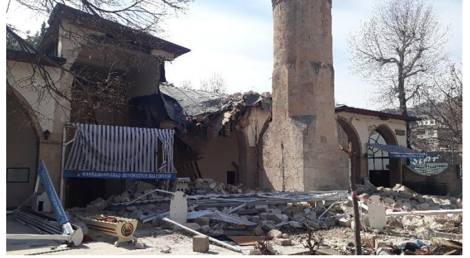
Şekil 4. Ulu Camii hasarlı görüntüsü
