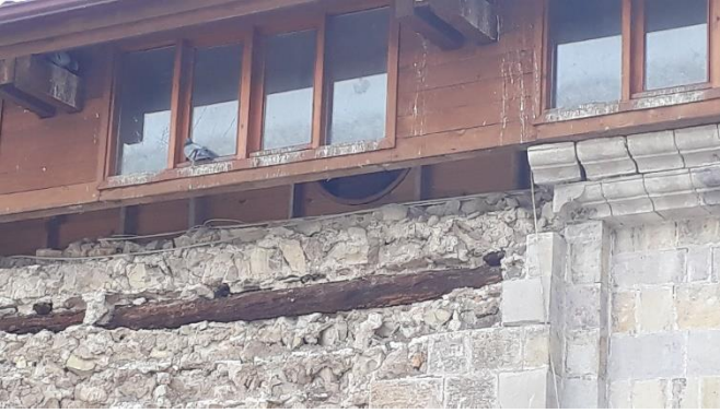
Şekil 8. Hasar gören Arasa camii
