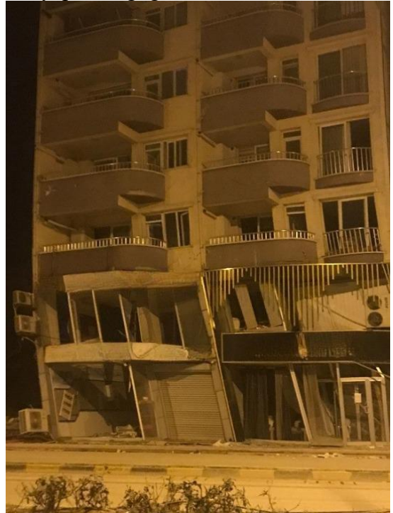
Şekil 9. 6 Şubat 2023 Kahramanmaraş depremlerinden sonra Hatay’da B1 düzensizliği nedeniyle ağır hasar alan yapı örneği
