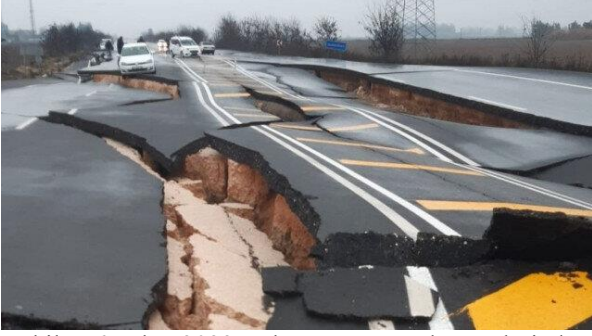
Şekil 5. 6 Şubat 2023 Kahramanmaraş depremlerinden sonra Kırıkhan-Reyhanlı yol hattında meydana gelen göçme hasarı [7]
