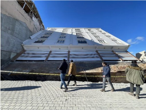
Şekil 17. 6 Şubat 2023 Kahramanmaraş depremlerinden sonra Adıyaman'da yapı-temel-zemin uyumsuzluğu nedeniyle ağır hasar alan yapının örneği [11]
