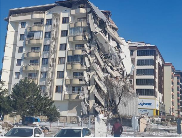
Şekil 7. 6 Şubat 2023 Kahramanmaraş depremlerinden sonra Malatya’da A2 düzensizliği nedeniyle ağır hasar alan yapı örneği
