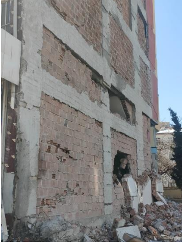
Şekil 13. 6 Şubat 2023 Kahramanmaraş depremlerinden sonra Kahramanmaraş'ta C1 düzensizliği nedeniyle hasar alan yapının kısa kolon etkisi örneği
