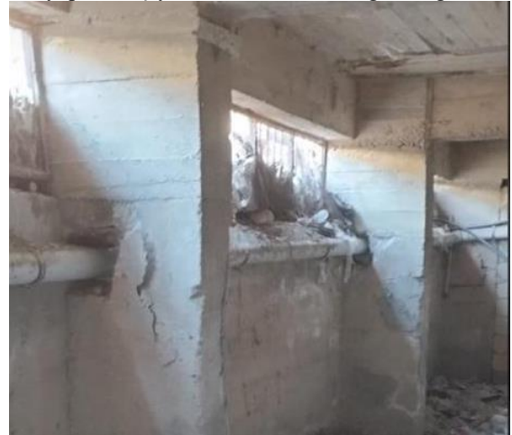
Őekil 12. 6 Şubat 2023 Kahramanmarař depremlerinden sonra Kahramanmarař’ta B3 düzensizliđi nedeniyle hasar alan yapının tařıyıcı eleman süreksizliđi örneđi
