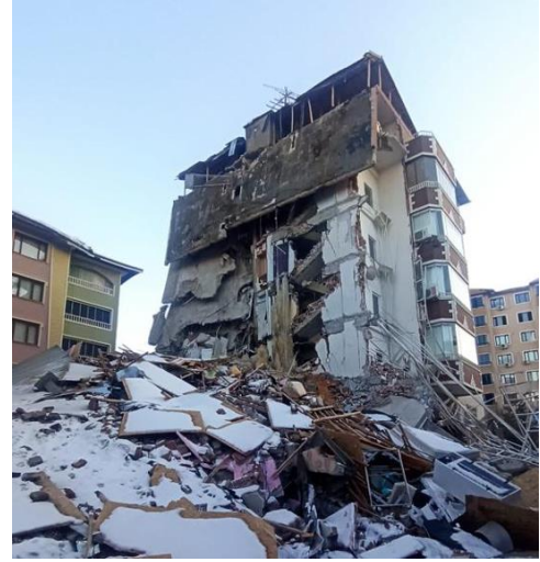
Şekil 15. 6 Şubat 2023 Kahramanmaraş depremlerinden sonra Malatya'da C3 düzensizliği nedeniyle ağır hasar alan yapının örneği
