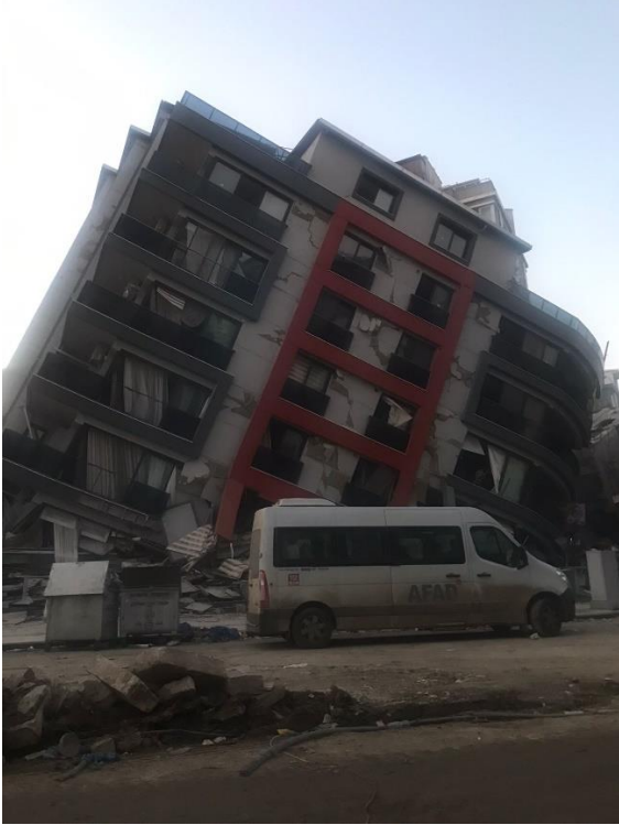
Őekil 10. 6 Şubat 2023 Kahramanmarař depremlerinden sonra Hatay’da B2 düzensizliđi nedeniyle ađır hasar alan yapı örneđi
