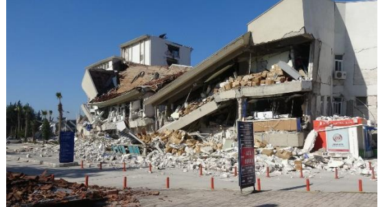
Şekil 3. 6 Şubat 2023 Kahramanmaraş depremlerinden sonra Hatay’da bir bölümü yıkılan Eğitim ve Araştırma Hastanesi [6]
