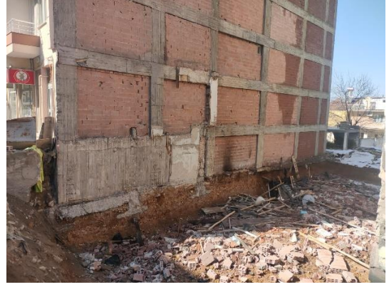
Şekil 14. 6 Şubat 2023 Kahramanmaraş depremlerinden sonra Malatya'da C2 düzensizliği nedeniyle hasar alan yapının taşıyıcı eleman görseli
