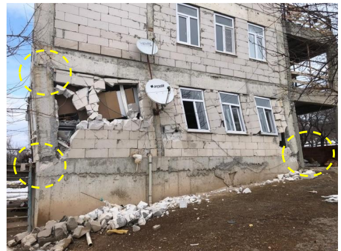
Şekil 13. Kolon-kiriş birleşim bölgesi hasarları
