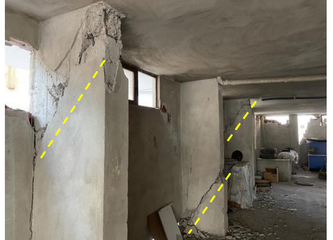
Şekil 17. Bant pencere ve kısa kolon etkisine bağlı hasarlar
