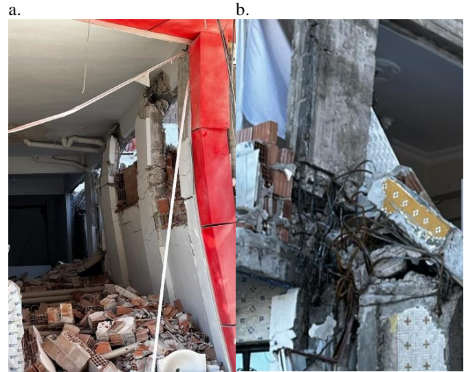
Şekil 12. Kolon-kiriş birleşim bölgesi hasarı
