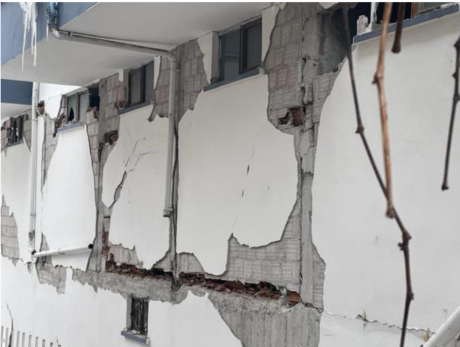
Şekil 22. Zemine bağlı oturma hasarları
