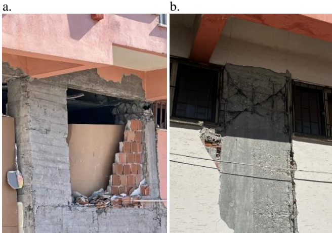
Şekil 19. Kısa kolon etkisine bağlı hasarlar
