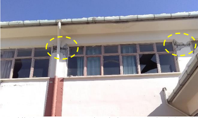
Şekil 18. Bant pencere ve kısa kolon etkisine bağlı hasarlar
