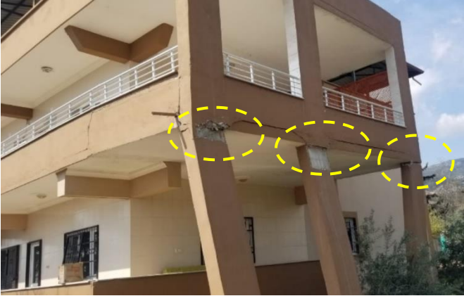
Şekil 14. Kolon-kiriş birleşim bölgesi hasarları
