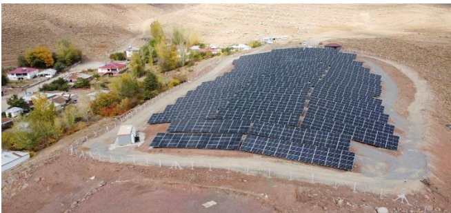
Şekil 8 Karlıova belediyesi güneş enerji santrali
