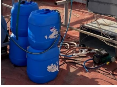
Şekil 3. Isı transfer akışkanı depoları ve pompaları
