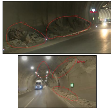
Şekil 1. Kahramanmaraş depremi sonrası tünellerde oluşan moloz dökülmesi ve yırtıklar [9]
